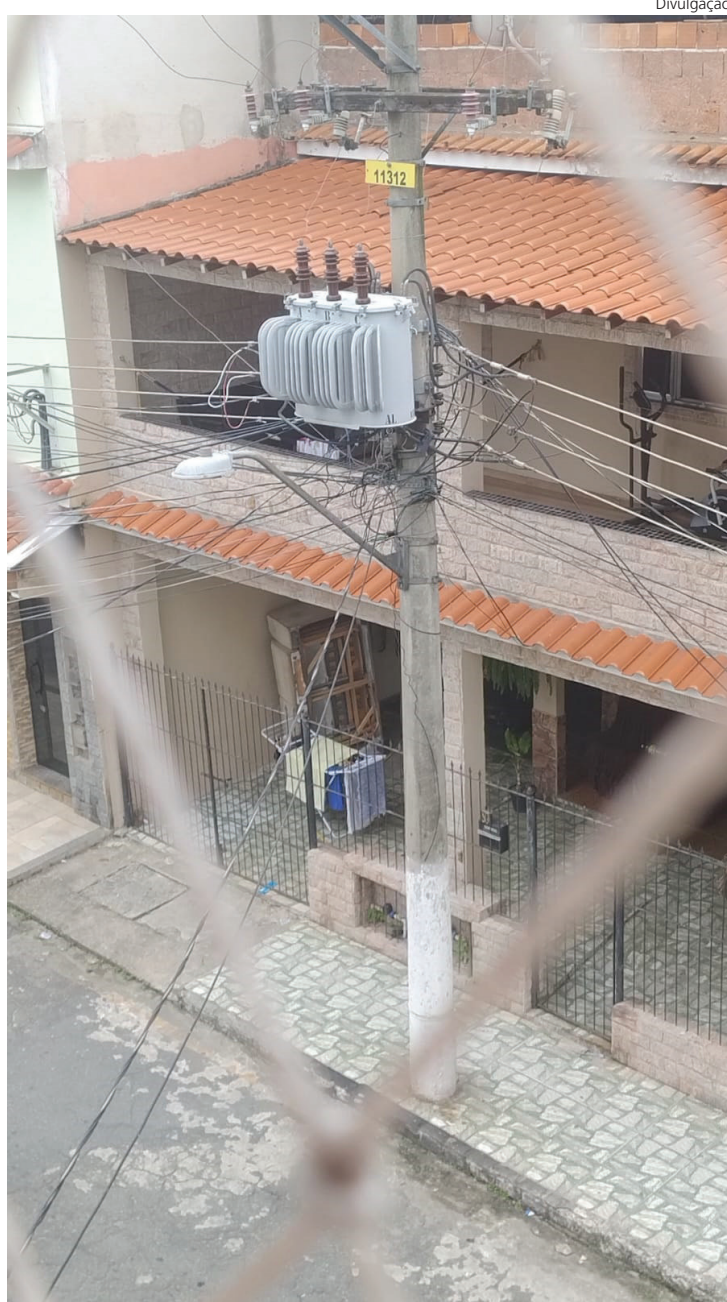
NO BAIRRO Vista Alegre, em Barra Mansa, moradores reclamam da Light
