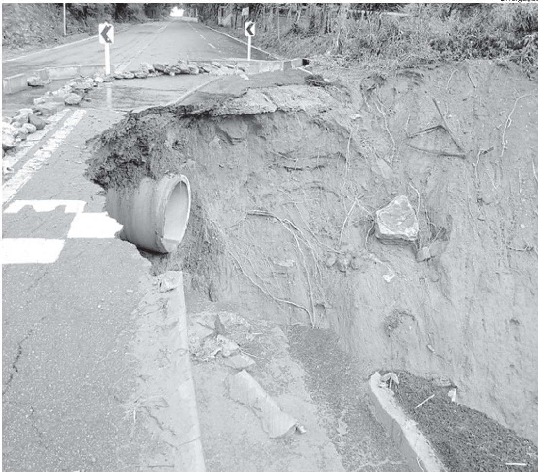
Novo deslizamento obrigou Defesa Civil de BM a tomar decisão sobre interdição total da RJ-153
