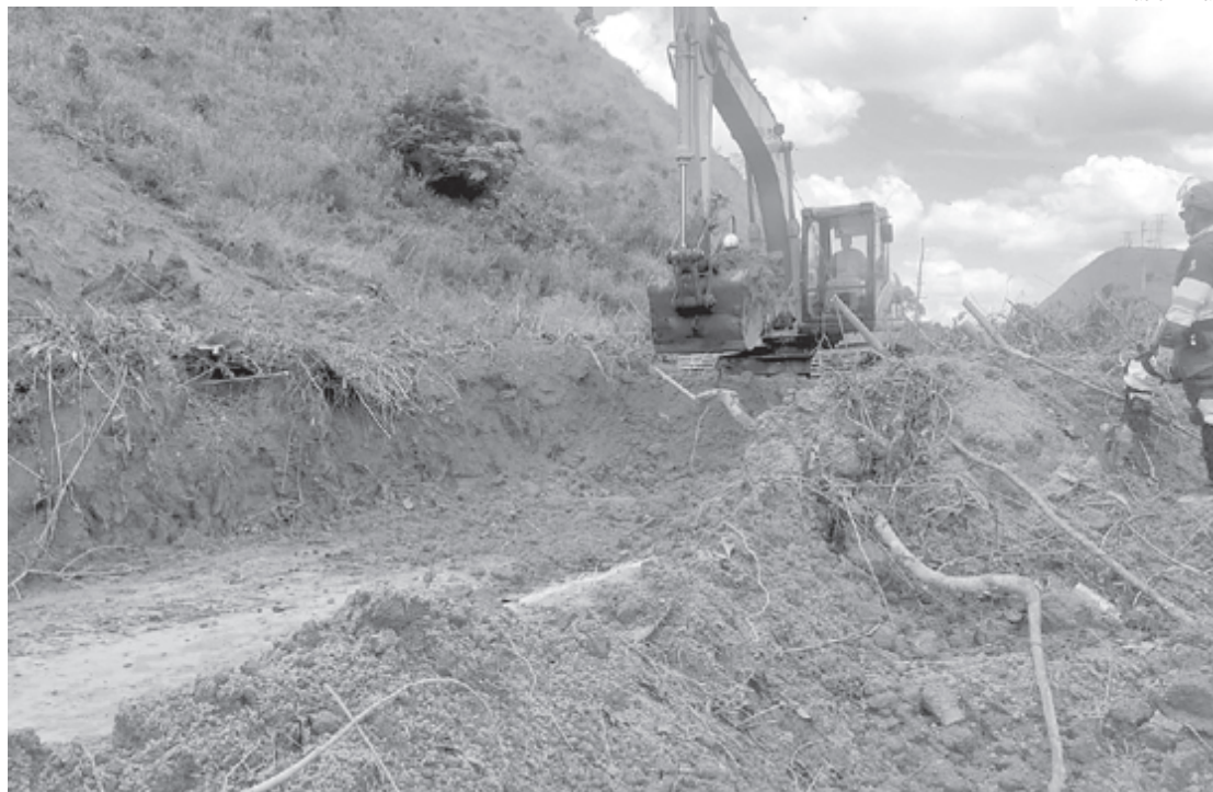
Risco: Instabilidade de algumas áreas da Serra da Araras coloca em risco a viagem no trecho em Pirai. Homens trabalharam o dia todo para liberar a pista
