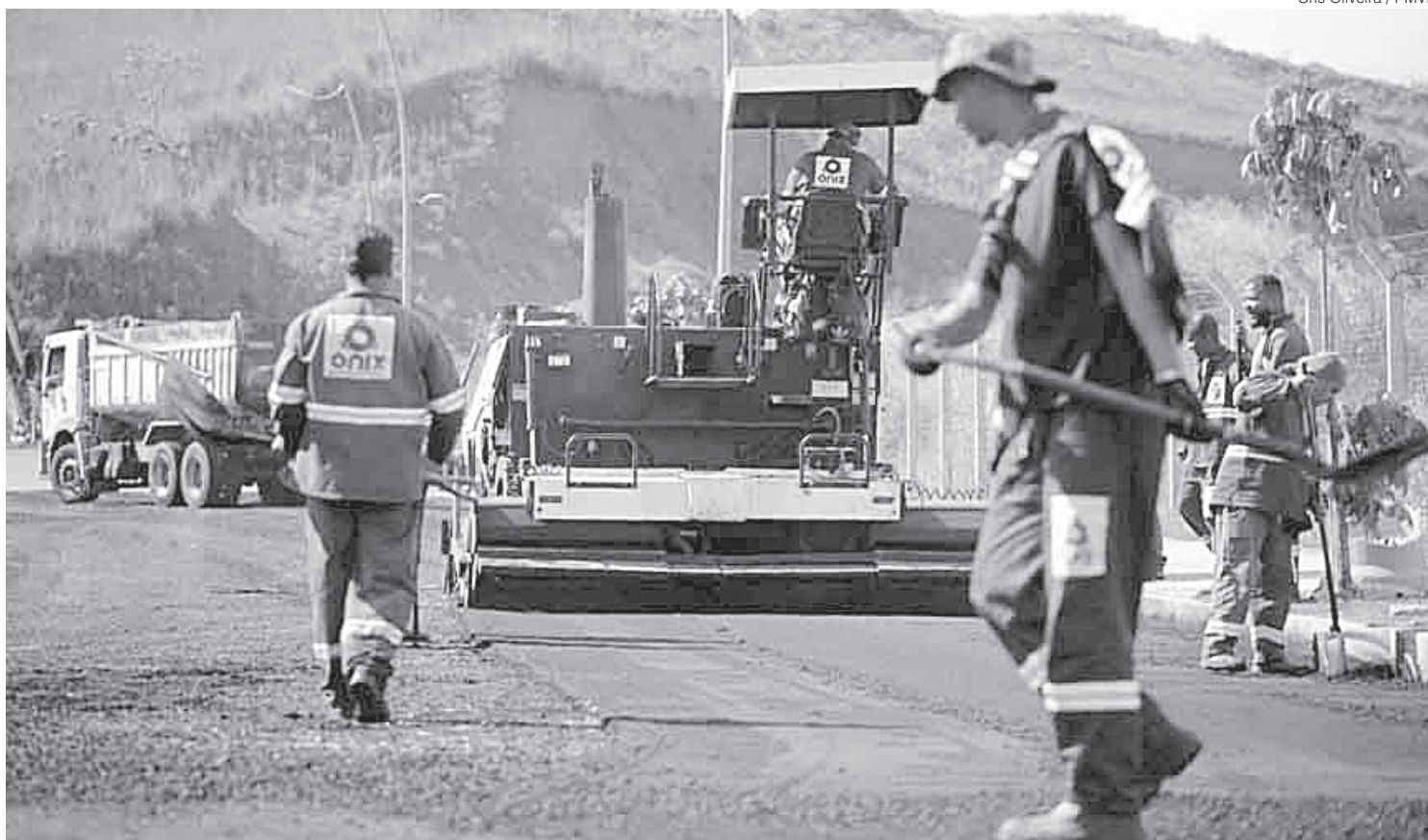
Serviços recuperam via da entrada do Portal da Saudade até o Mergulhão, próximo do acesso ao Hospital São João Batista
