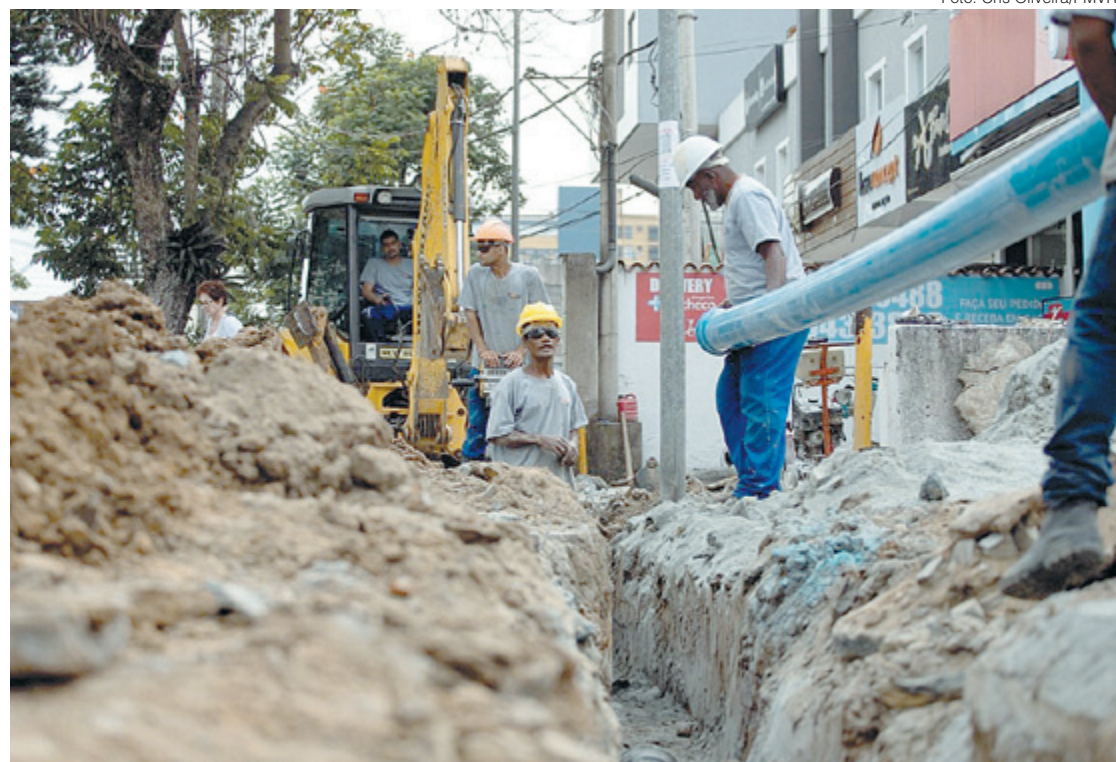
Troca da tubulação está concentrada neste momento em apenas um lado da Rua 33, na Vila Santa Cecília, em Volta Redonda
