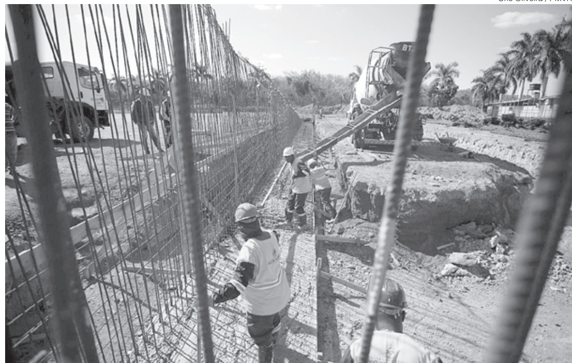
Estrutura faz parte de um projeto maior de Mobilidade Urbana que vai ajudar a desafogar o trânsito da cidade
