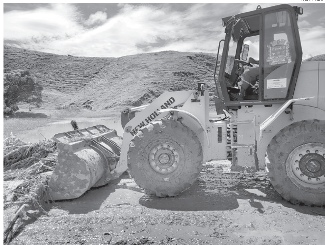
Máquinas estão trabalhando para recuperar estradas no distrito de São José do Turvo
